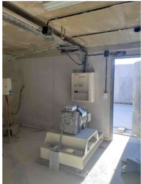
T. Arcos – Sala Ascensores Piso 35º.
