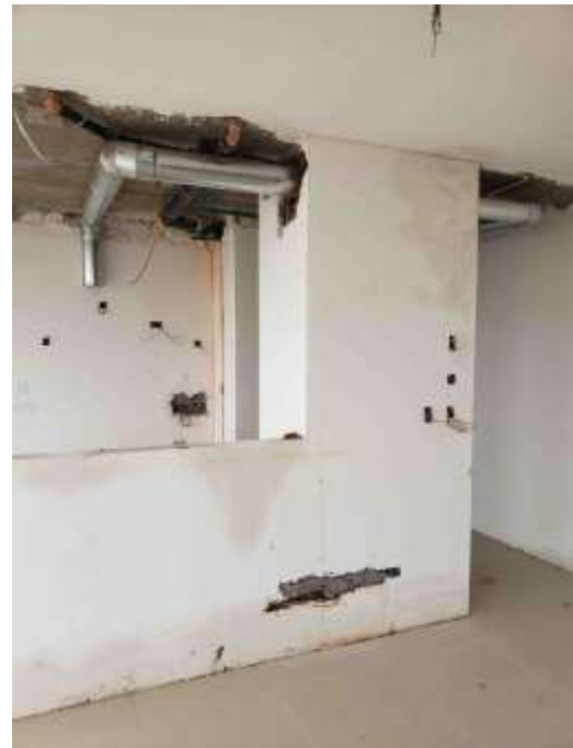
T. Arcos – Extracción Cocina Piso 11°.
