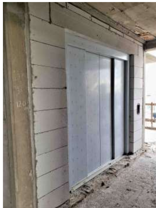
Torre Arcos – 33°.P – Frente Ascensor
