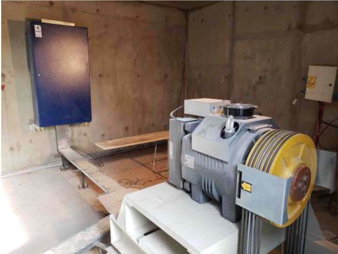
Torre Arcos – Piso 35°. Sala de Máquinas Ascensor No.9
