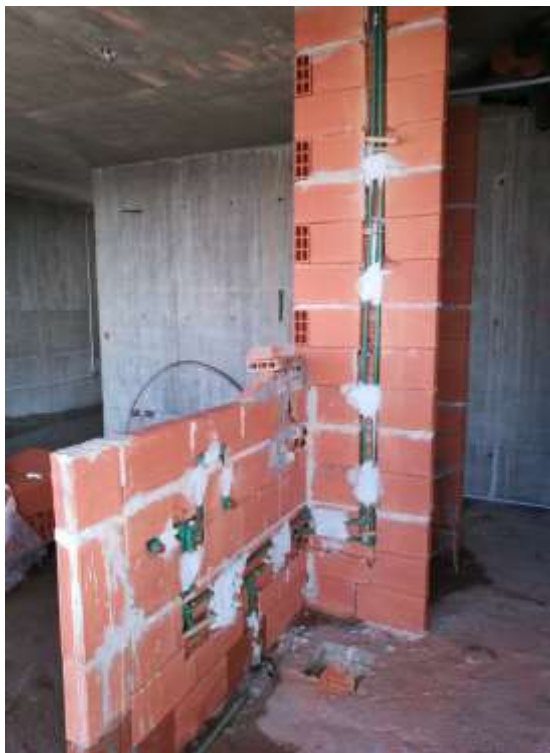
Torre Arcos – Instalaciones Piso 34º.
