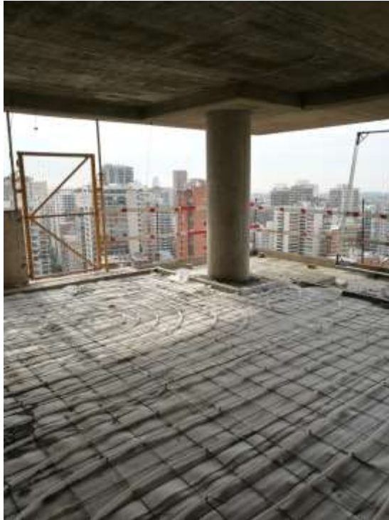
Torre Arcos – Piso 25°. Piso Radiante
