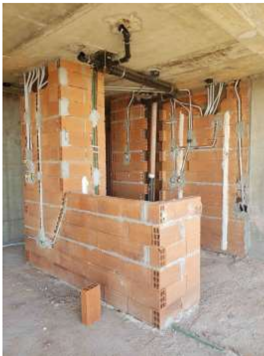
Torre Arcos – Piso 29º. Inst. Cloacal
