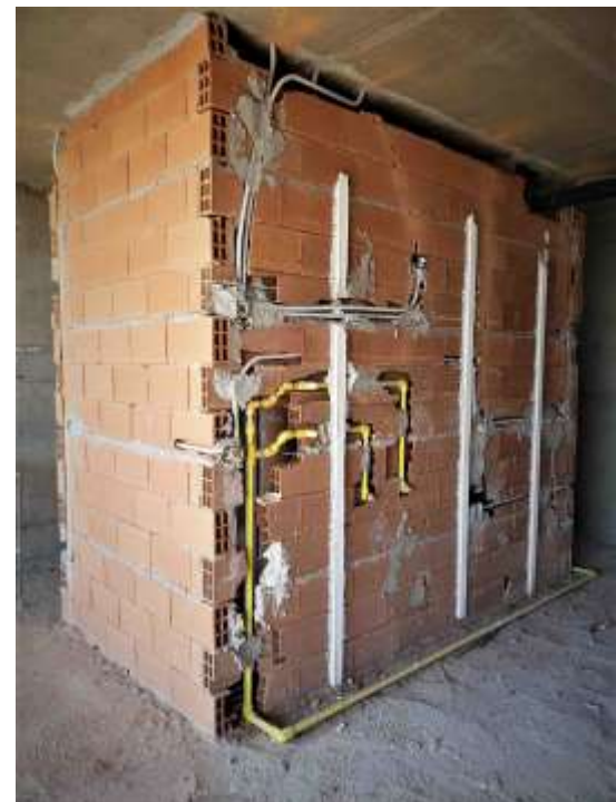
Torre Arcos – Piso 29º. Inst. de Gas
