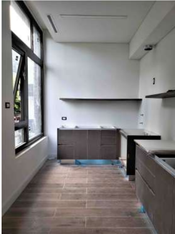
Torre Zabala – Piso 1°. Cocina Amenities
