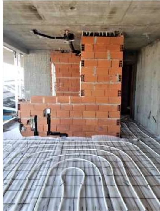
Torre Arcos – Piso 22°. Piso Radiante
