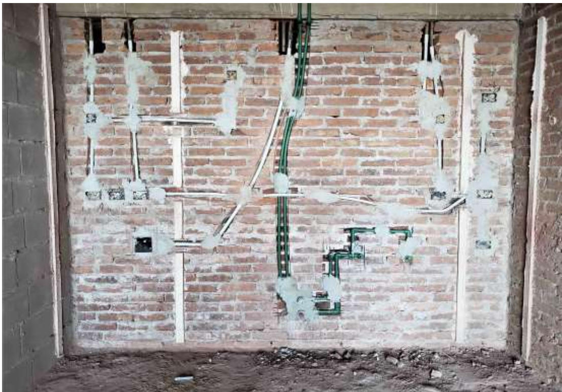
Torre Arcos – Piso 29°. Fajas e Instalaciones
