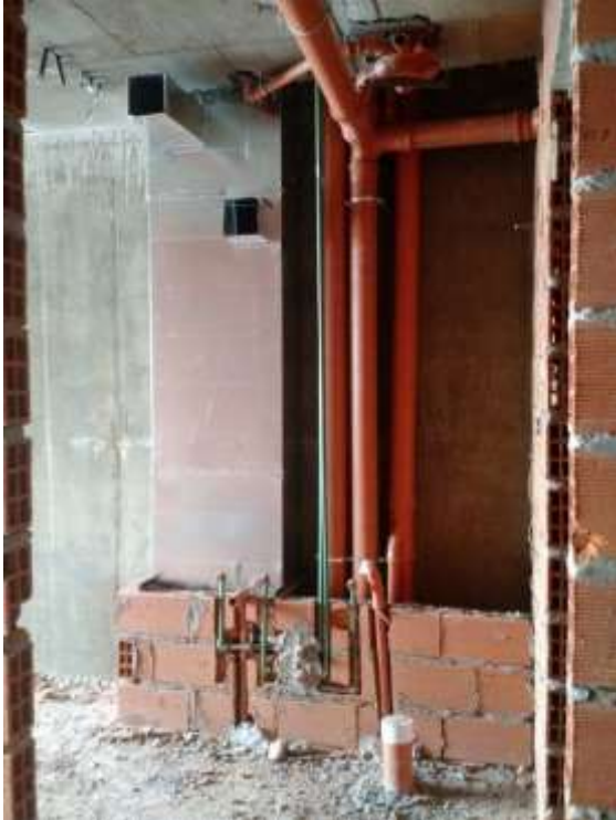
Torre Zabala – Inst. Extracción 6º.P
