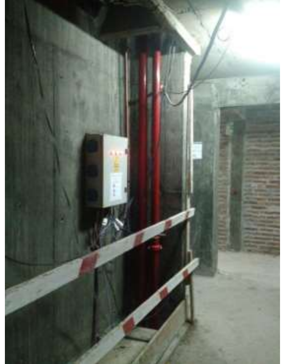
Torre Zabala – Inst. Incendio 7º.P
