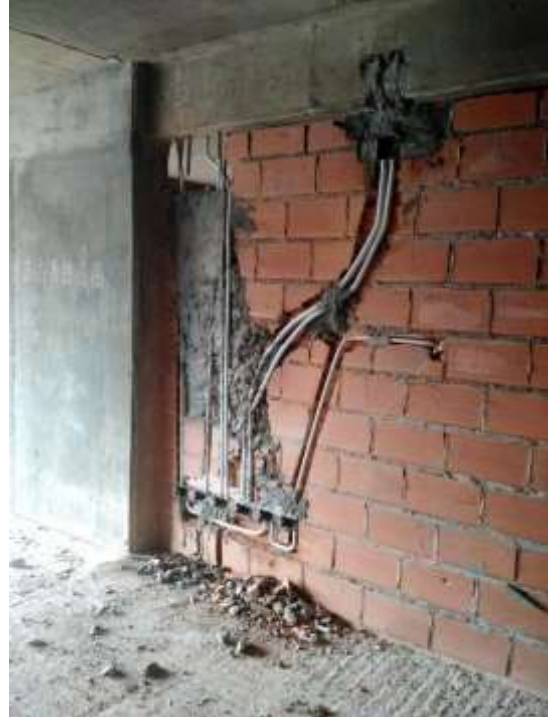
T. Zabala – Instalación Eléctrica 7º.P
