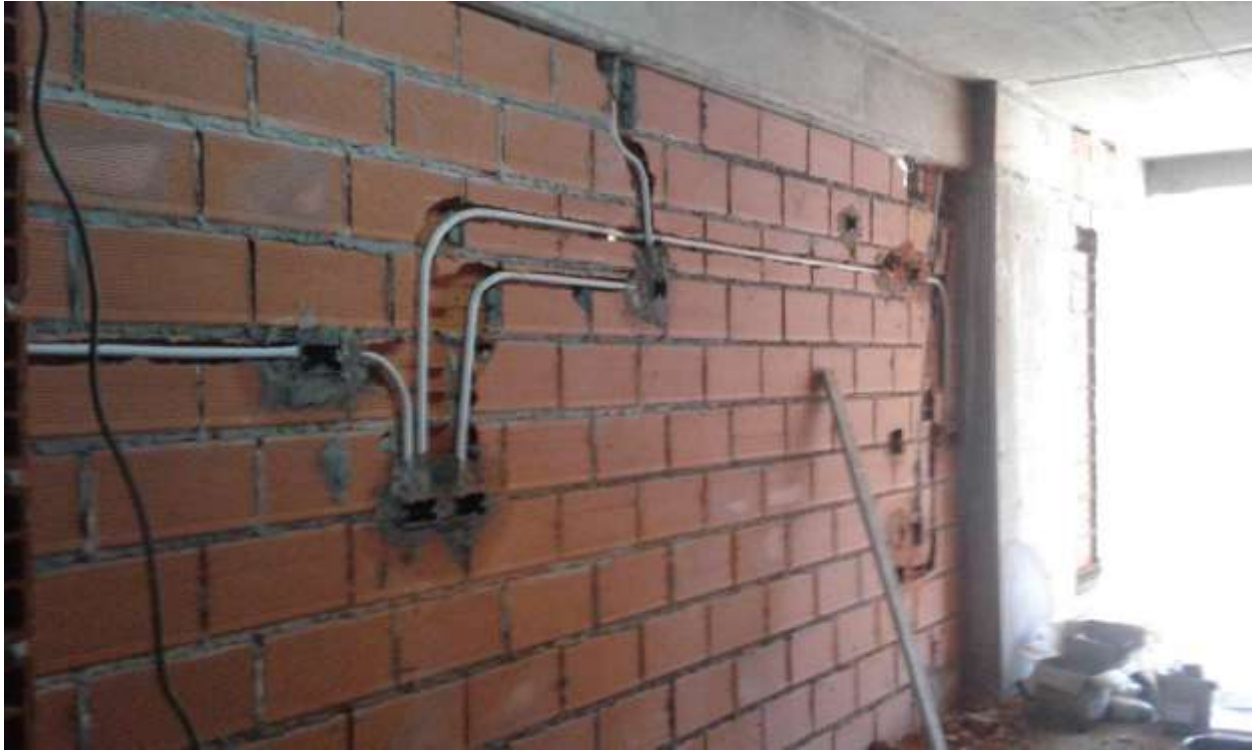
Torre Zabala – Canalización Eléctrica en Mampostería
