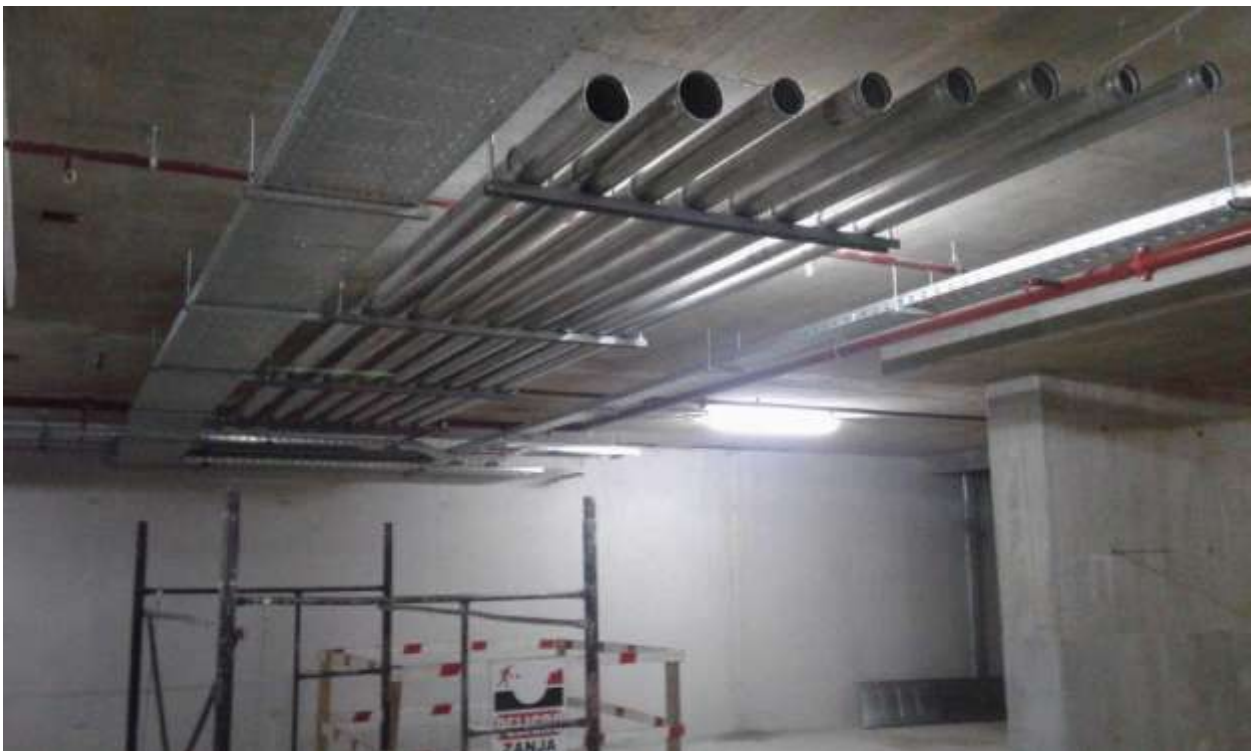
Torre Zabala – Bandejas y Cañerías de Agua Fría
