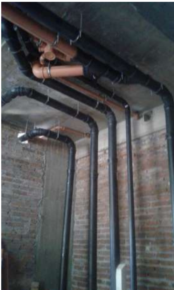
Torre Zabala – Instalación Cloacal 1er.P
