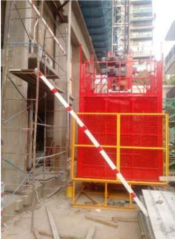
Torre Zabala – Instalación Montapersonas
