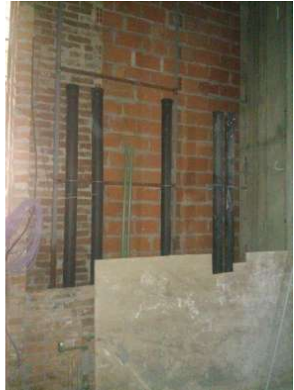
Torre Zabala - Montantes Cloacales
